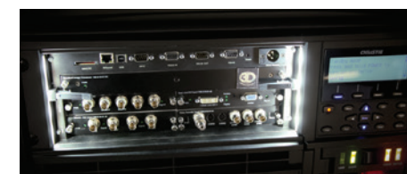
▲ Luces para instalación
